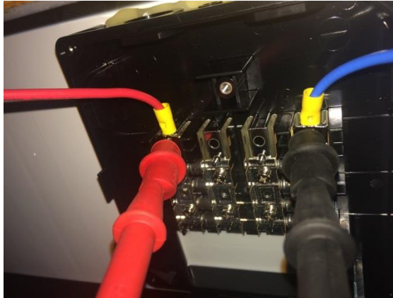
Figura 3. Caixa de conexão do circuito ao painel solar.
